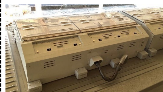
水素貯蔵ユニット
